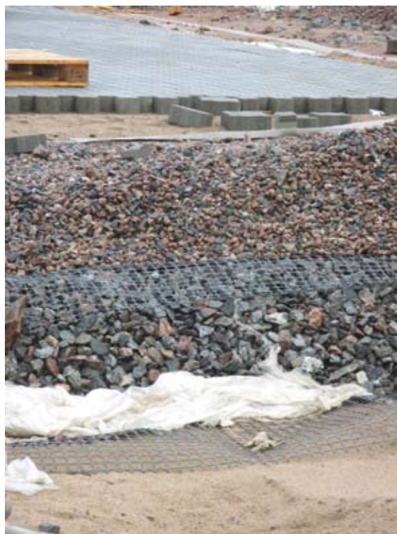
Рис. 10. Конструктивные слои дорожной одежды из искусственных камней мощения (сверху вниз): камень мощения “Волна” (1Ф.10)-100 мм; песок морской (мелкозернистый)-30 мм; геотекстиль; щебень гранитный фр. 20-40 с расклинровкой - 250 мм; георешётка; щебень фр. 40-70 с расклинровкой -300 мм; георешётка; песок морской (мелкозернистый) – 480 мм; геотекстиль.
