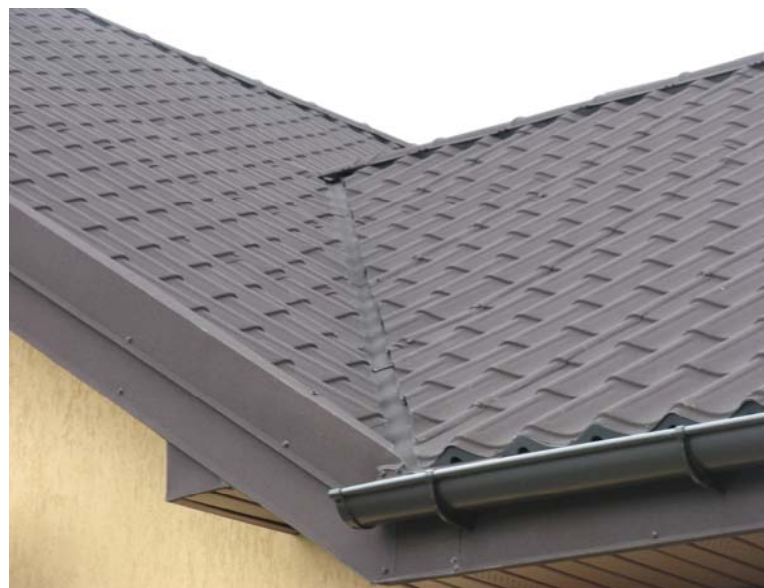
Рис. 75. Отсутствие декоративной накладки на ендове
